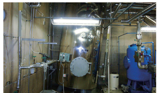
高砂老人福祉センターでは、ボイラーが傾き、配管破裂しました
