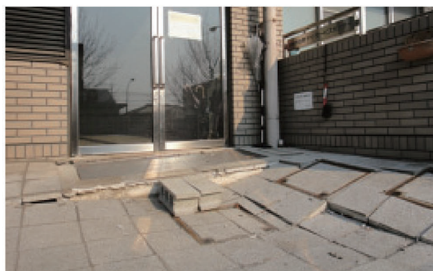
台原デイサービスセンターでは、玄関のブロックが破損しました
